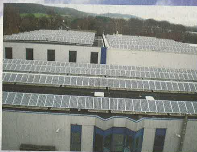
Photovoltaik-Anlage mit 100 kWp
